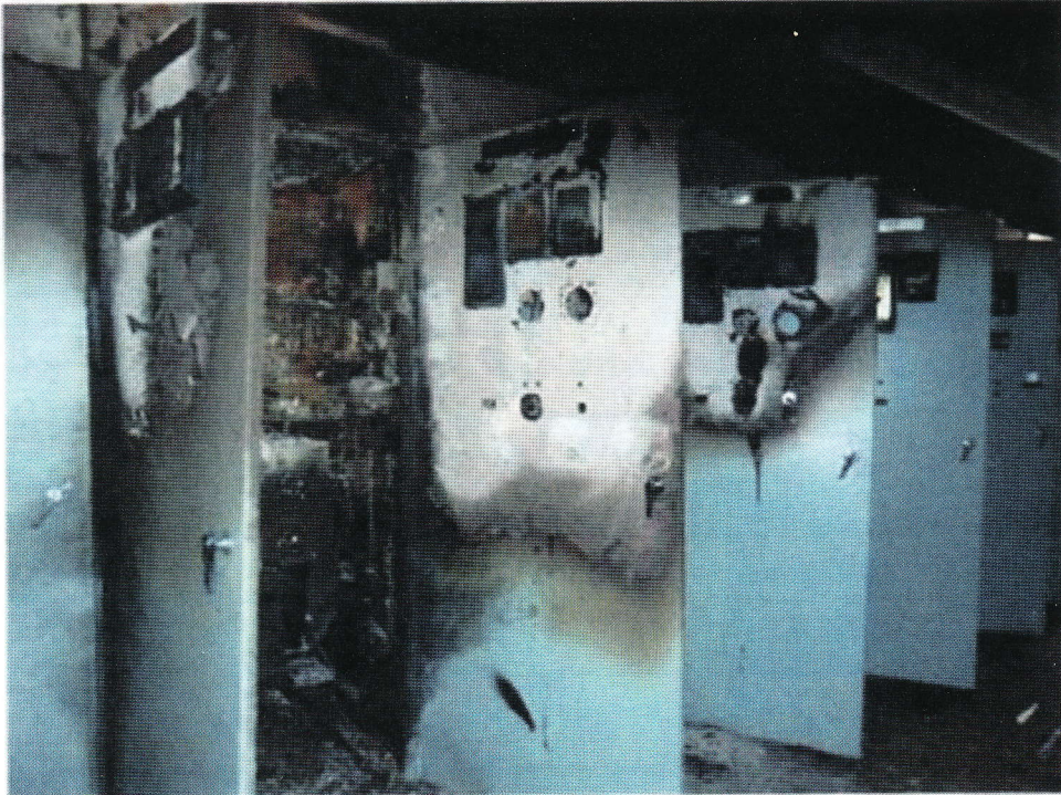
高圧電源盤 現場写真
