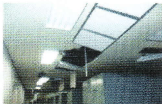
天井化粧板の脱落
