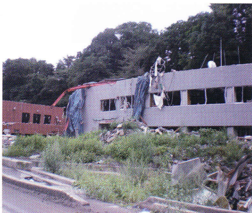
津波で流された県の原子力防災センター（女川）
