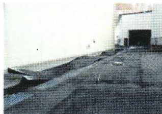
舗装道路陥没
